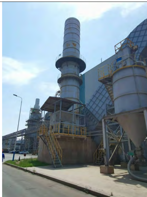
废钢切割、冷修废气、中包倾翻废气、风淬废气排气筒
