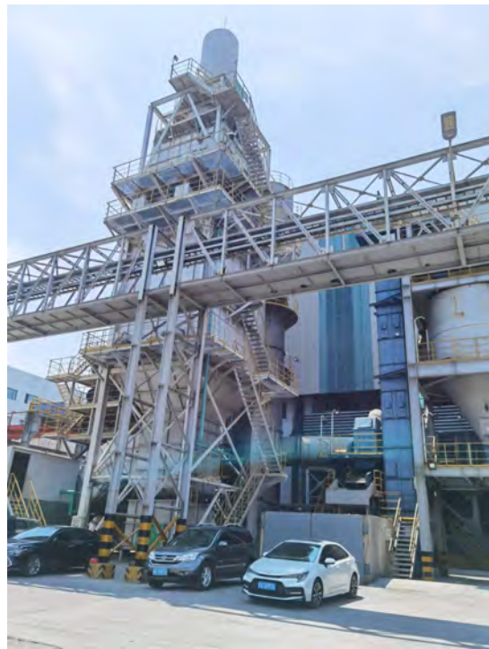
2#湿电除尘废气排气筒
